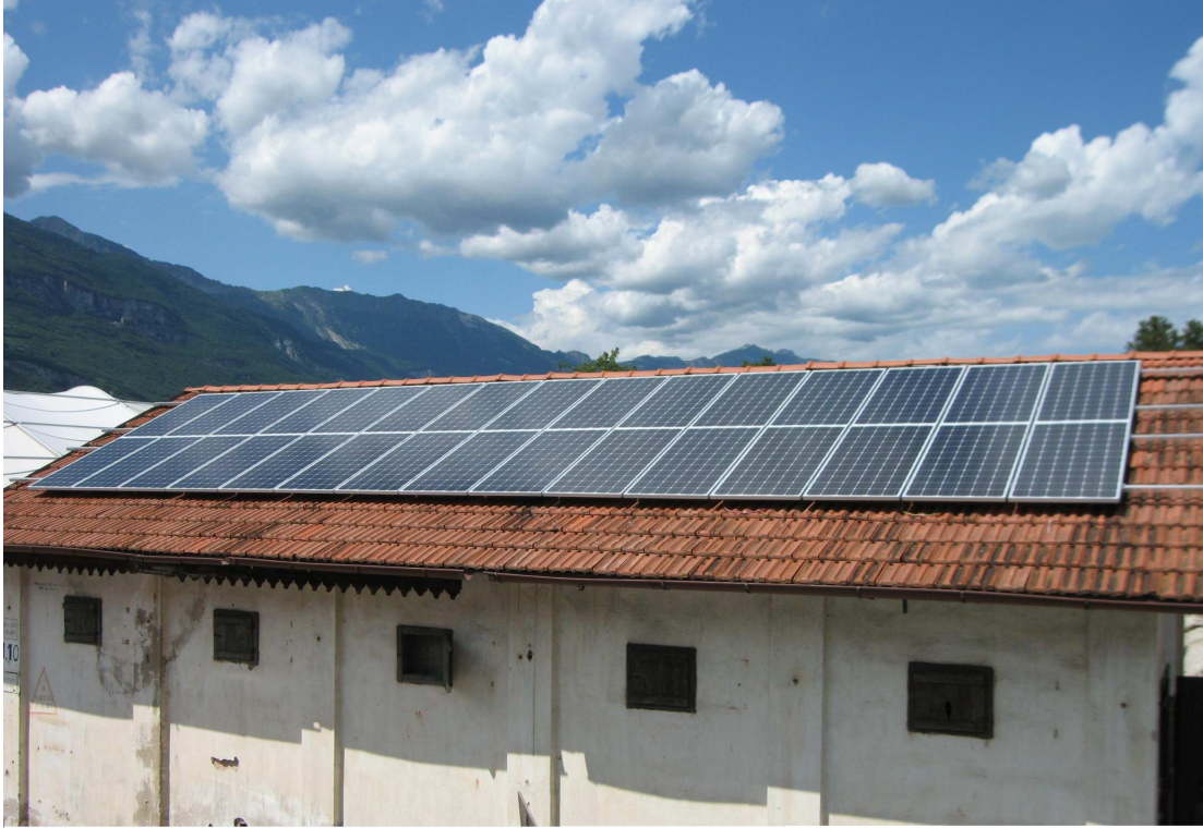
Figura 4-1: impianto fotovoltaico sperimentale presso il Centro di Protezione Civile di Marco di Rovereto
