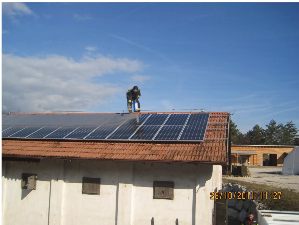
Figura 5-18: Prova con PreventoSolar: inizio terza spruzzata, copertura di tutti i pannelli
